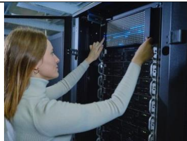
Bildunterschrift: Die Q.ANT NPU ist als schlüsselfertiger Native Processing Server (NPS) erhältlich und kann in jedes HPC oder Rechenzentrum integriert werden. (Bild: Q.ANT GmbH)
